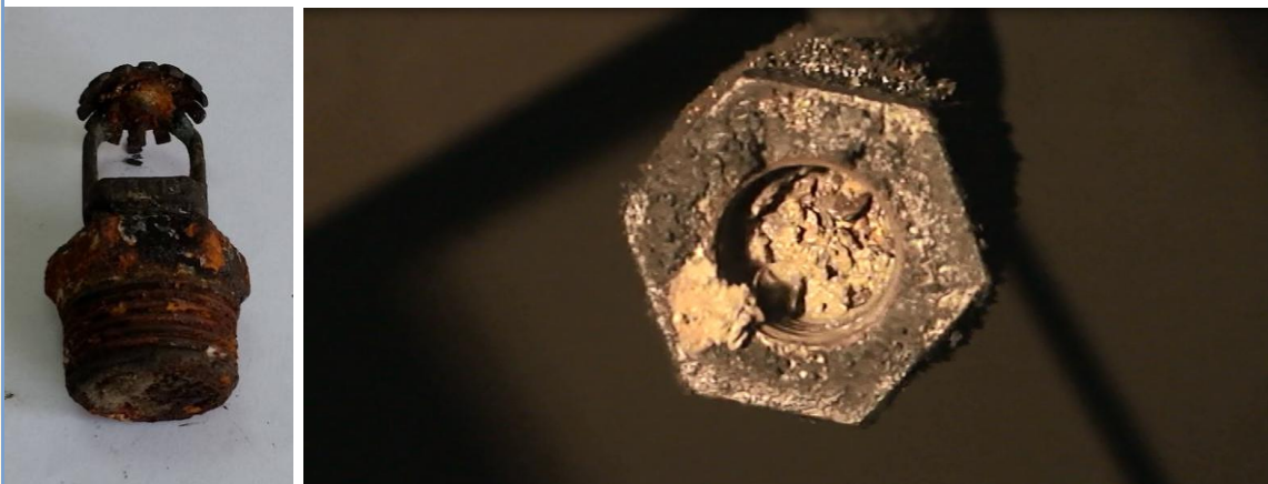
Φραγμένη κεφαλή και σωλήνα του συστήματος “DRENCHER”
